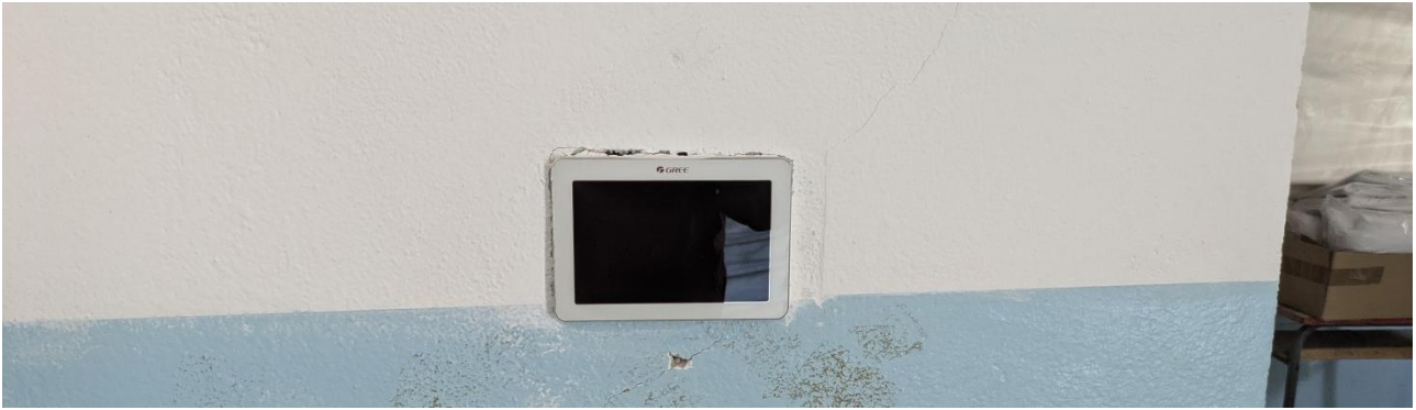
Figura 18 - centralina impianto di condizionamento esistente
