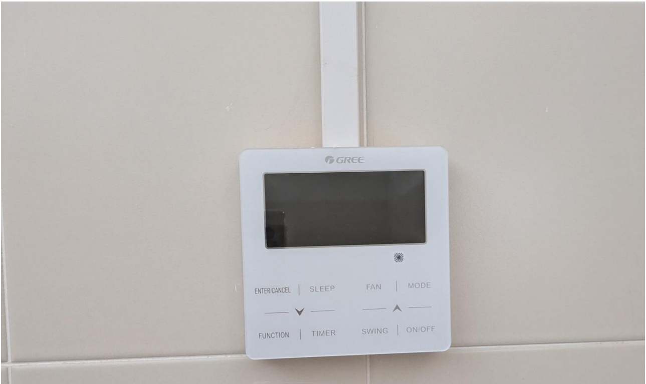
Figura 19 - termostato ambiente - impianto di condizionamento esistente
